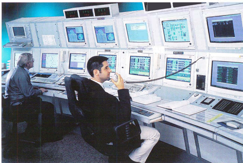
Salle de contrôle de la configuration au sol
